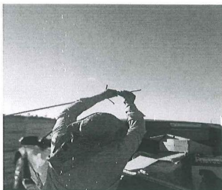
Verificación del pararrayos
