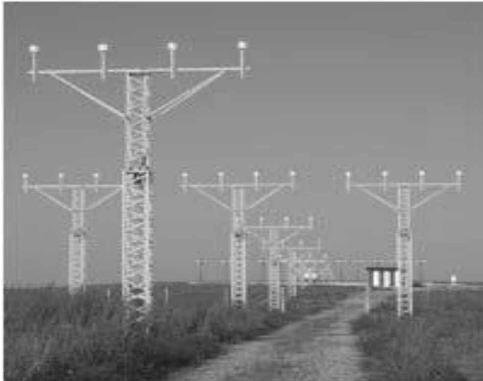
Figura 2-8-2. Torres de iluminación de aproximación de fibra de vidrio.-
