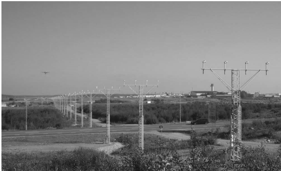
Figura 2-6-2. Torres de iluminación de aproximación — Estructuras reticulares de fibra de vidrio.-
