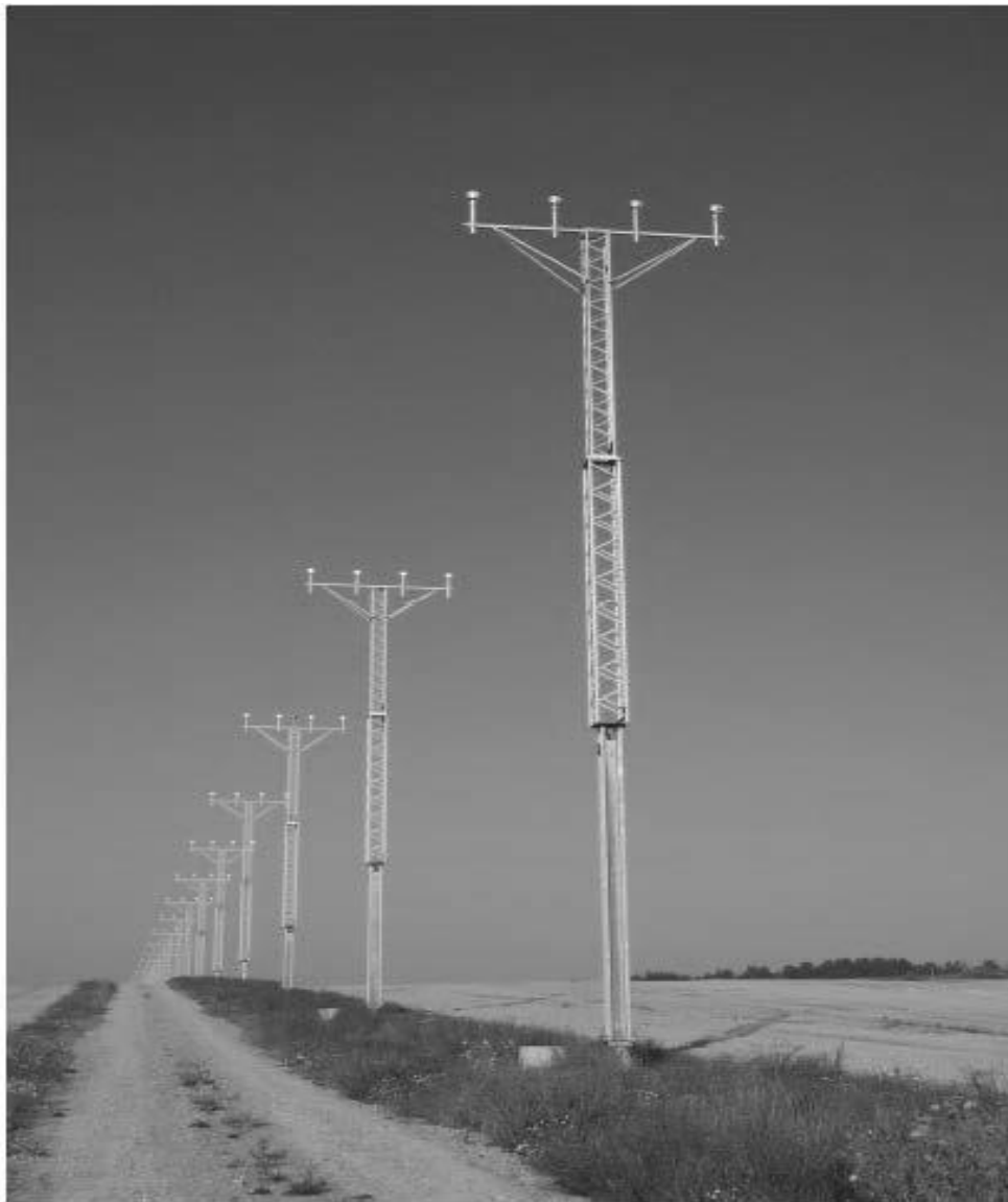
Figura 2-8-1. Torres de iluminación de aproximación de fibra de vidrio sobre estructuras de soporte rígidas.-
