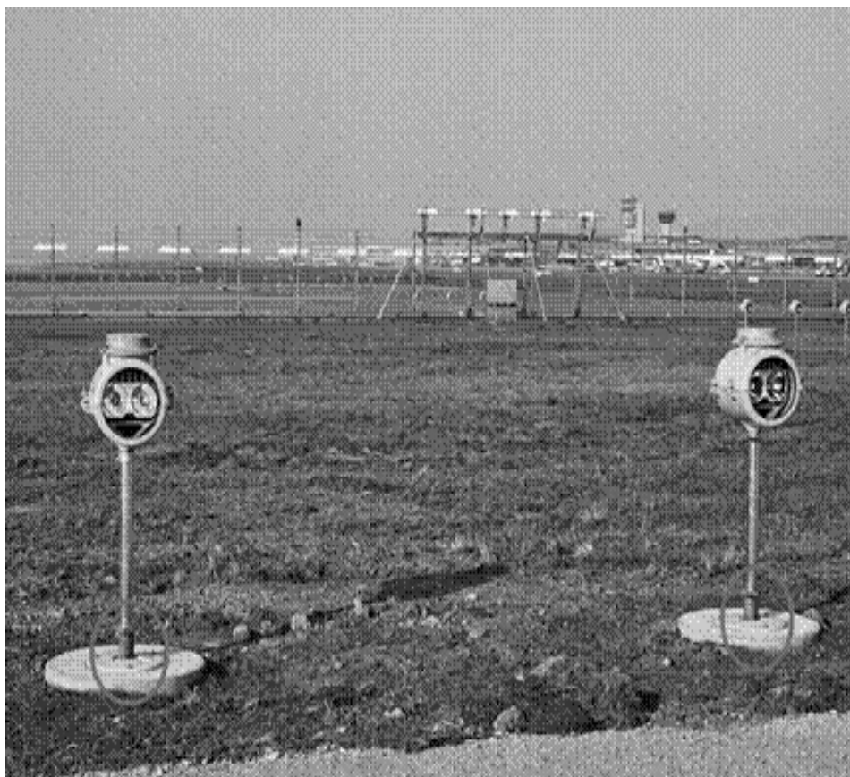
Figura 2-6-4. Ejemplos de Cuplas Frangibles montaje de tubos en luces de aproximación.-
